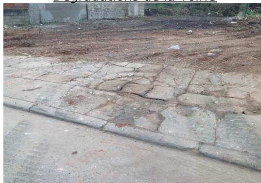
Dégradations de la voirie
